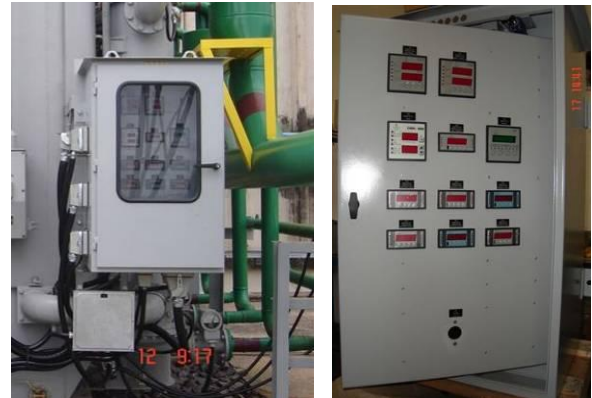
Fig. 8. Panel con sensores inteligentes (IEDs) en el cuerpo del transformador.
