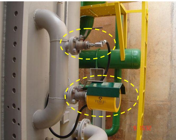
Fig. 5. Monitor de humedad (arriba) y de gas disuelto en el aceite.
