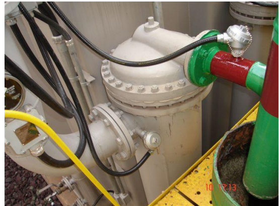
Fig. 7. Sensores de temperatura de entrada de aceite y salida de agua de los cambiadores de calor.
