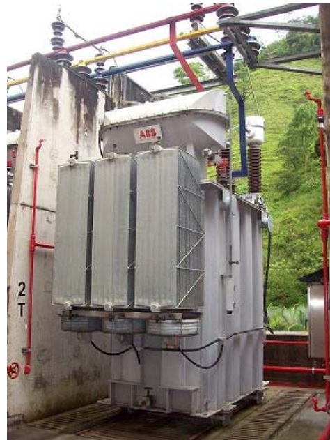
Ilustración 3. Transformador piloto para el monitoreo y control de temperatura.
