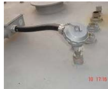
Ilustración 4. Sensor PT100 instalado.
