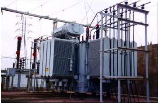
El transformador modernizado: durante cuatro años, ninguna desconexión para mantenimientos e inspecciones de rutina y seguimiento.
