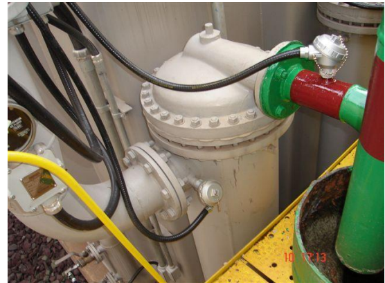
Fig. 7. Sensores de temperatura de entrada de óleo e saída de água dos trocadores de calor.
