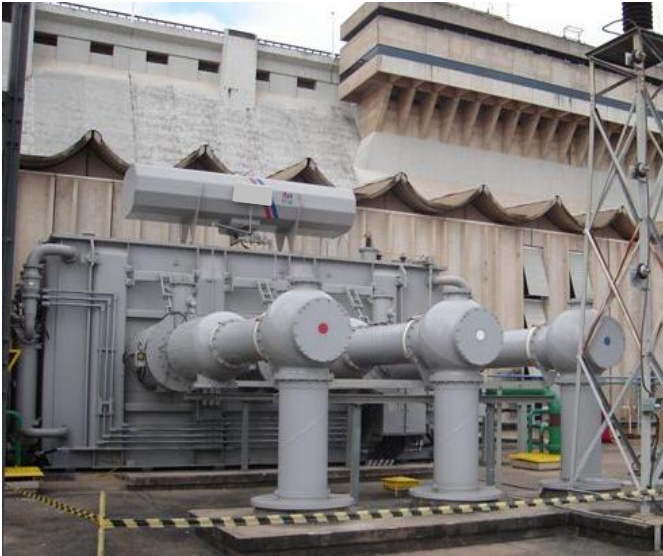
Fig. 3. Vista de um dos transformadores elevadores, 378 MVA 13,8/550 kV.
