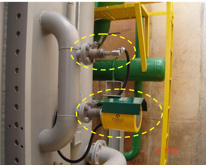
Fig. 5. Monitor de umidade (acima) e de gás dissolvidos no óleo.
