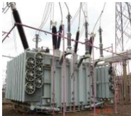
Fig. 1 – Transformador regulador R1
