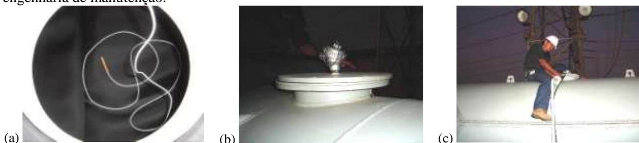
Fig. 8 – Instalação do sensor de ruptura de membrana do tanque de expansão. (a) Sensor sobre a membrana, no interior do tanque; (b) Caixa de ligação no topo do tanque; (c) Conexão do cabo do sensor.
