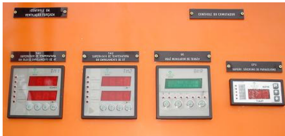
Figura 5 – Foto dos IED's Instalados
