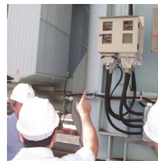
Figura 1 – IEDs no corpo do transformador Asea
