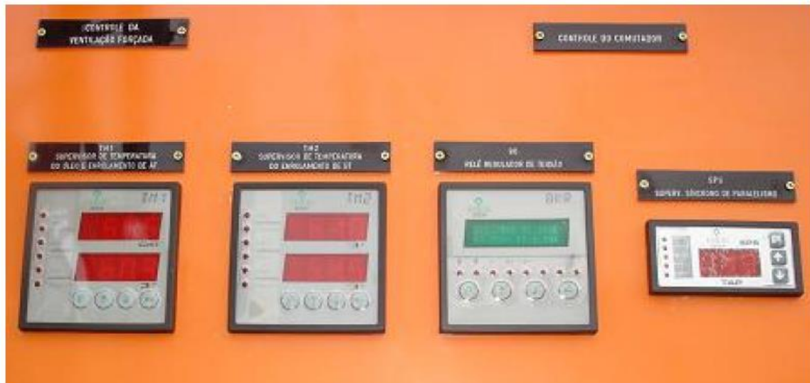
Figura 5 – Foto de los IEDs Instalados.
