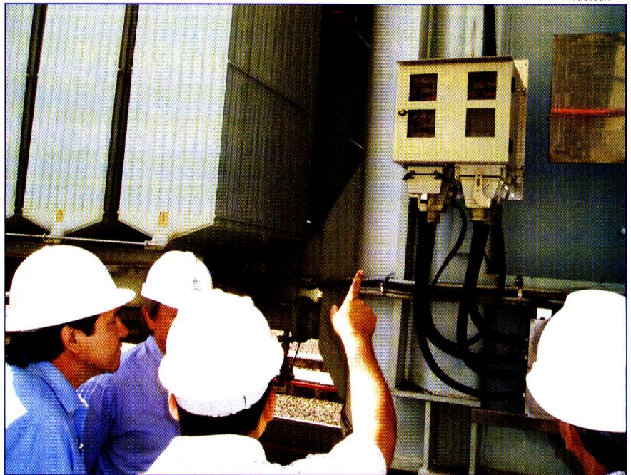
Fig. 2 – IEDs no corpo do transformador Asea
