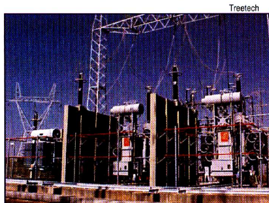
Fig. 1 – Banco de autotransformadores AT-04
