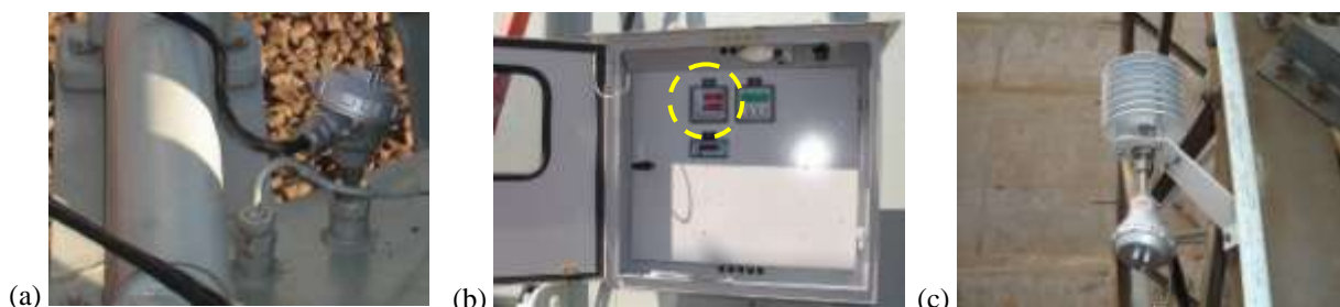
Fig. 6 – Medição de temperaturas. (a) Sensor de temperatura do topo do óleo; (b) Monitor de temperatura do óleo e do ponto mais quente do enrolamento; (c) Sensor de temperatura ambiente.
