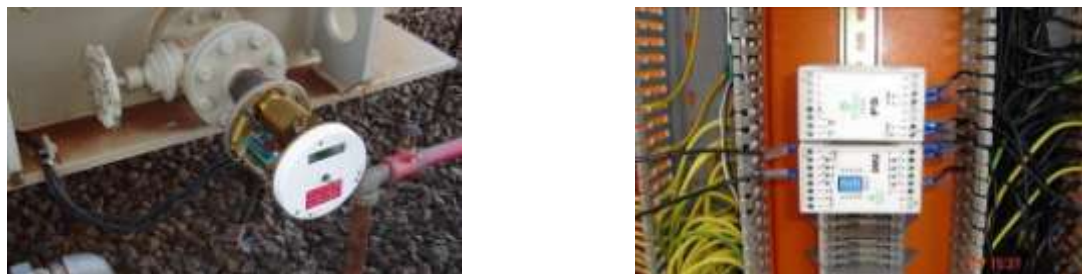
Fig. 4 – Integração do monitor de gás existente no regulador R4 ao sistema de monitoração. (a) Sensor de hidrogênio; (b) Módulo de aquisição de dados para integração.
