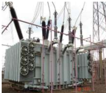
Fig. 1 – Transformador regulador R1
