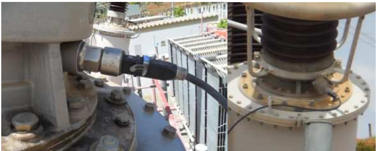
Figura 04: Detalhe dos adaptadores de tap utilizados no sistema de monitoração de buchas BM na SE Mesquita.
