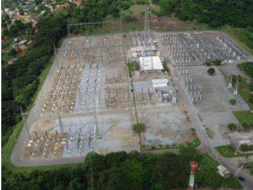
Figura 02: Vista aérea da SE Mesquita, pertencente a Cemig, situada na região leste de Minas Gerais
