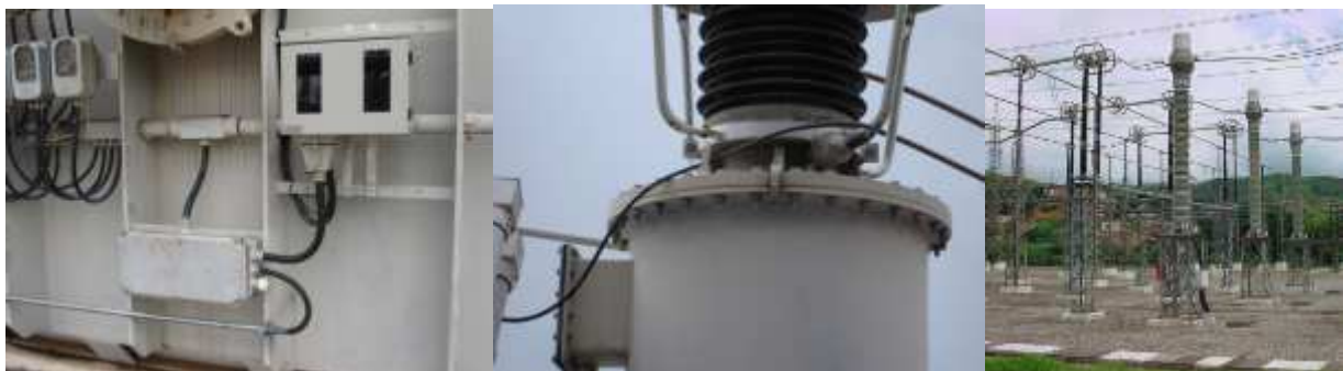
Figura 03: Detalhe das instalações do Sistema de Monitoração realizadas na SE Mesquita, da Cemig
