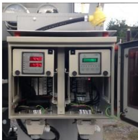
Fig. 05 - Monitores de Temperatura e Buchas
