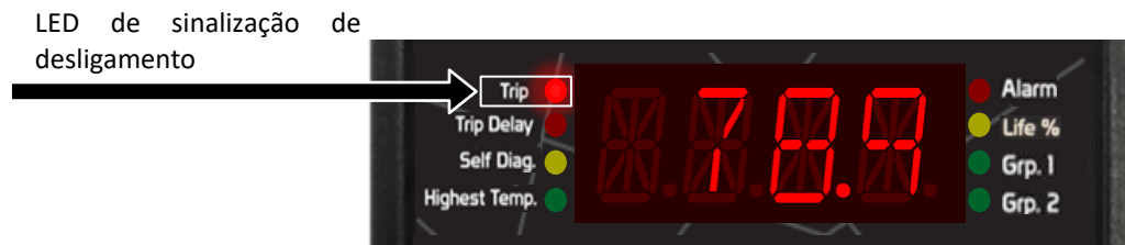
Figura 26 - LED de sinalização de desligamento
