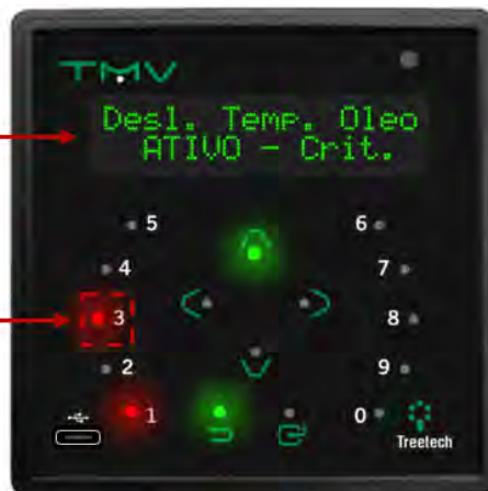
Figura 28 - Indicação de desligamento por temperatura do óleo ou enrolamento
